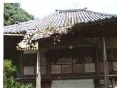
崩れかかった瓦屋根
