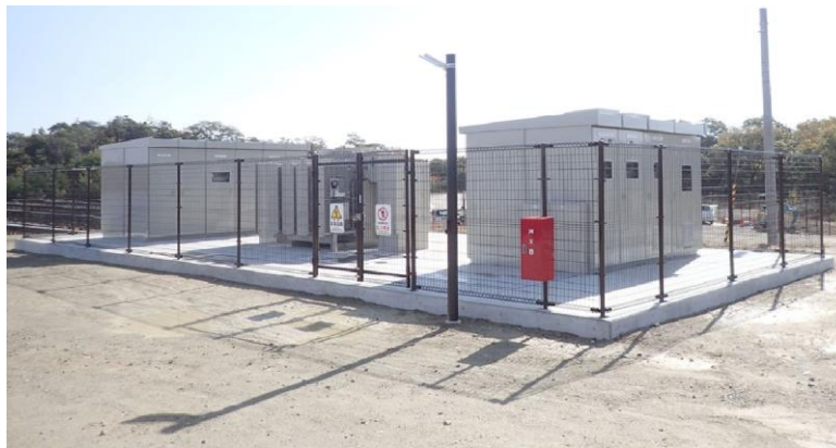
写真 1.4-3 受変電設備（設置イメージ）
