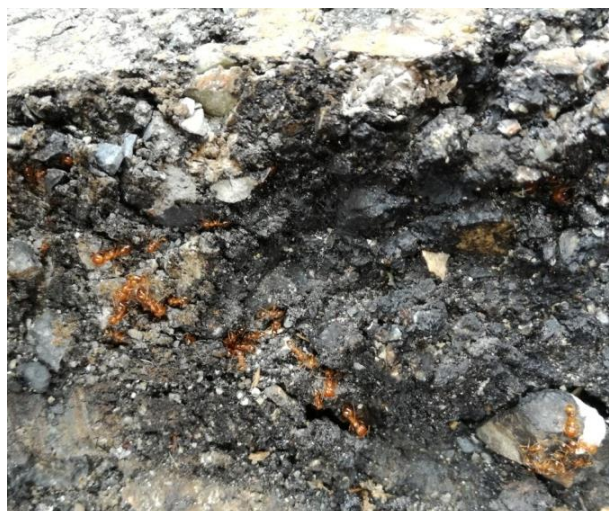
舗装亀裂部で発見されたアカカミアリ
