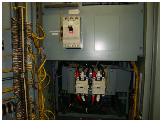
電気室の配電盤改造後の盤内状況
