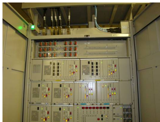
信号通信機器室の信号機器設備
