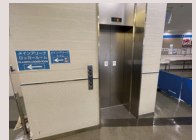
エレベーター
