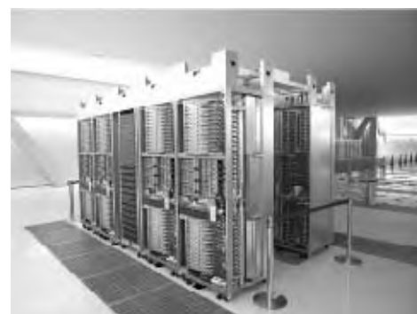
京速コンピュータ（京） 計算機筐体
