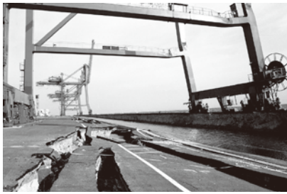
六甲アイランドコンテナターミナルの被災
