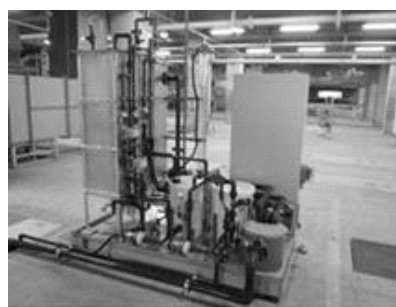
ポートアイランド処理場の水処理棟に設置された MBR 実験装置
