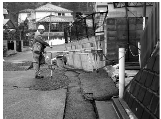
写真－4 東日本大震災で出現した宅地の被害（写真奥が左側に変状）
