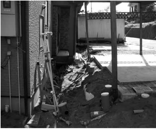
写真－3 中越沖地震による宅地の液状化被害
